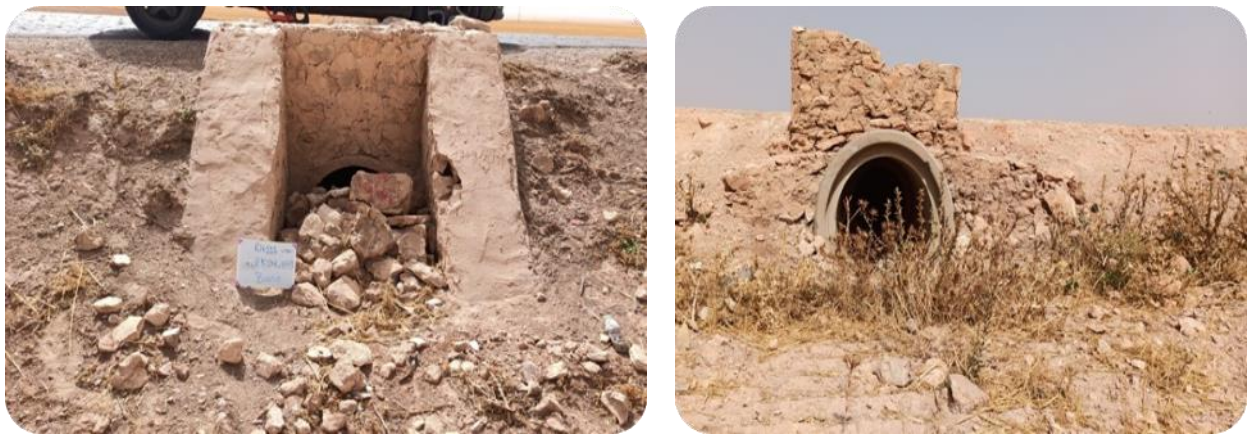
Passage busé obstrué et le mur de retour détruit
